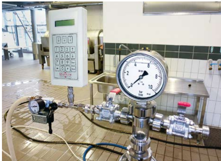
>> TESTGERÄT ZUM DURCHFÜHREN des Druckhaltetests (Integritätstest)
